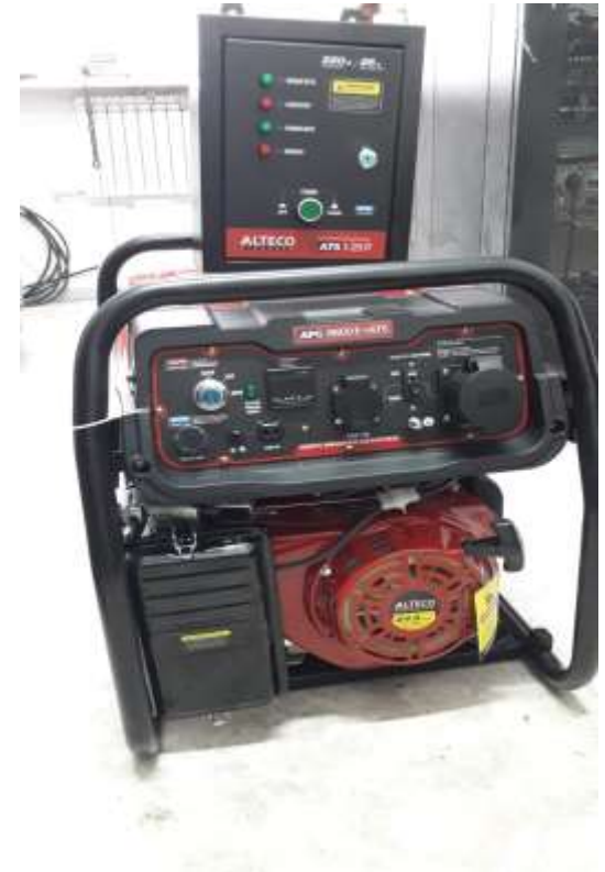
Двигатель аварийного электропитания
