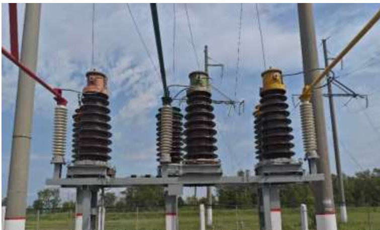
«До» замены трансформаторов тока 110 кВ
