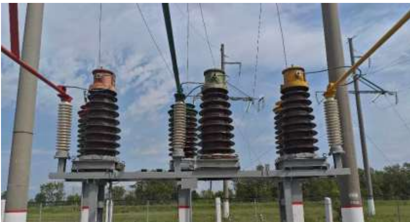
«До» замены трансформаторов тока 110 кВ
