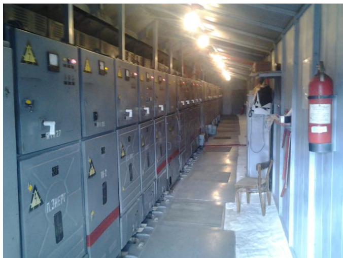
Фото до замены масляных выключателей 10 кВ
