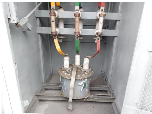
Фото до замены трансформаторов напряжения 10 кВ
