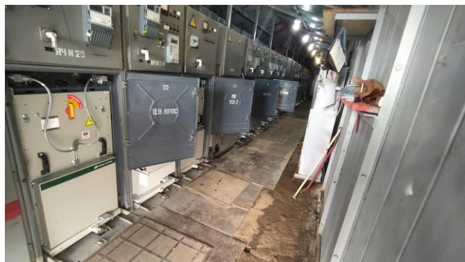
Фото после замены масляных выключателей 10 кВ
