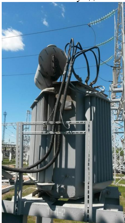
Фото до замены трансформаторов собственных нужд 6 кВ
