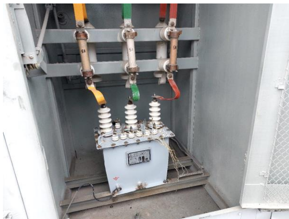
Фото после замены трансформаторов напряжения 10 кВ
