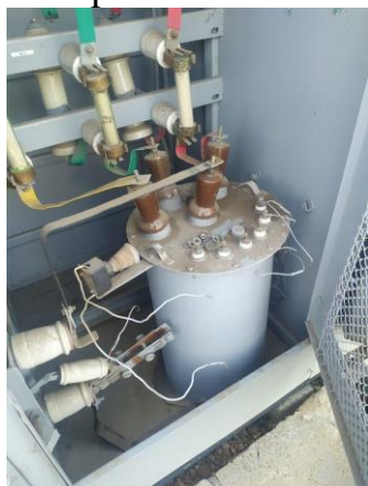
Фото до замены трансформаторов напряжения 10 кВ
