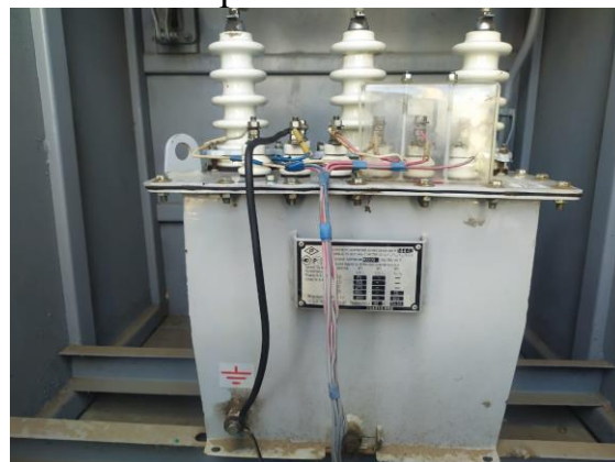
Фото после замены трансформаторов напряжения 10 кВ
