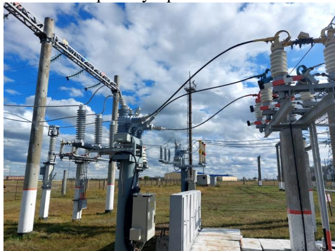
Фото после монтажа реклоузеров 35 кВ
