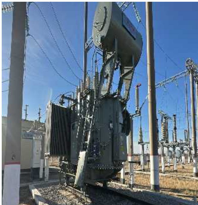
Фото после замены силовых трансформаторов
