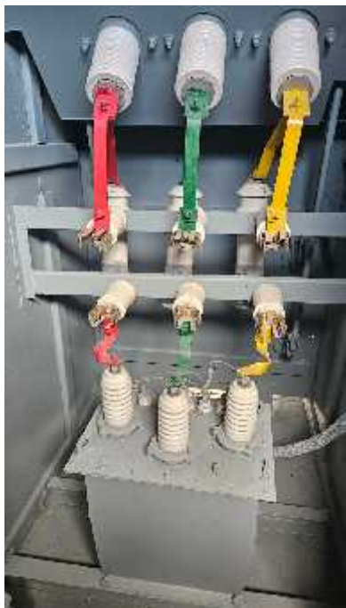
Фото до замены трансформаторов напряжения 10 кВ
