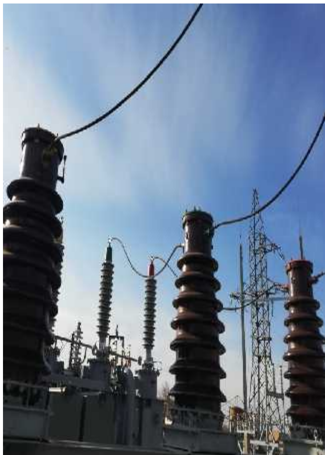
Фото до замены трансформаторов тока 110 кВ
