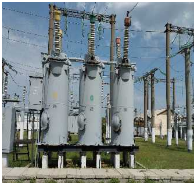
Фото до замены масляных выключателей 110 кВ
