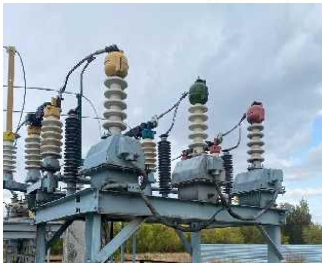
Фото до замены трансформаторов напряжения 35 кВ
