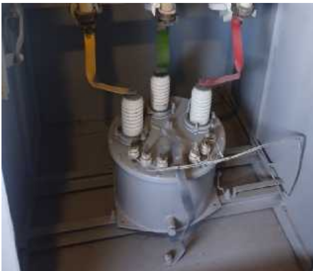
Фото до замены трансформаторов напряжения 10 кВ
