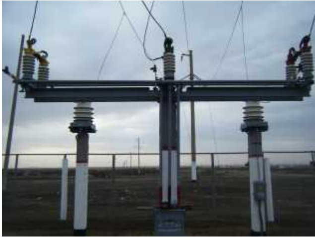
Фото до замены трансформаторов тока 35 кВ
