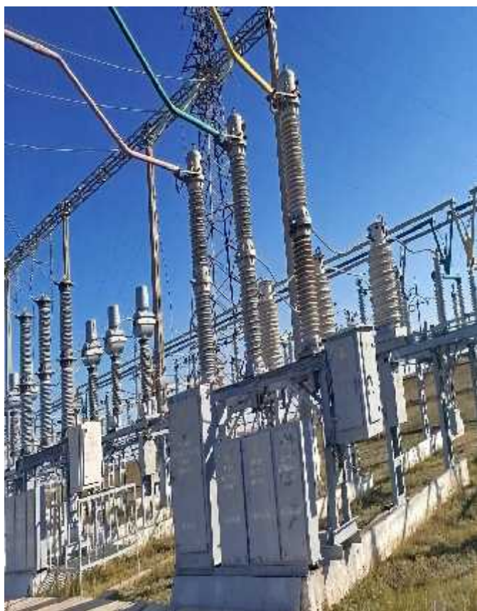
Фото до замены масляного выключателя 110 кВ
