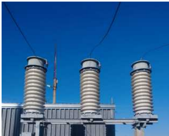
Фото до замены трансформаторов напряжения 110 кВ
