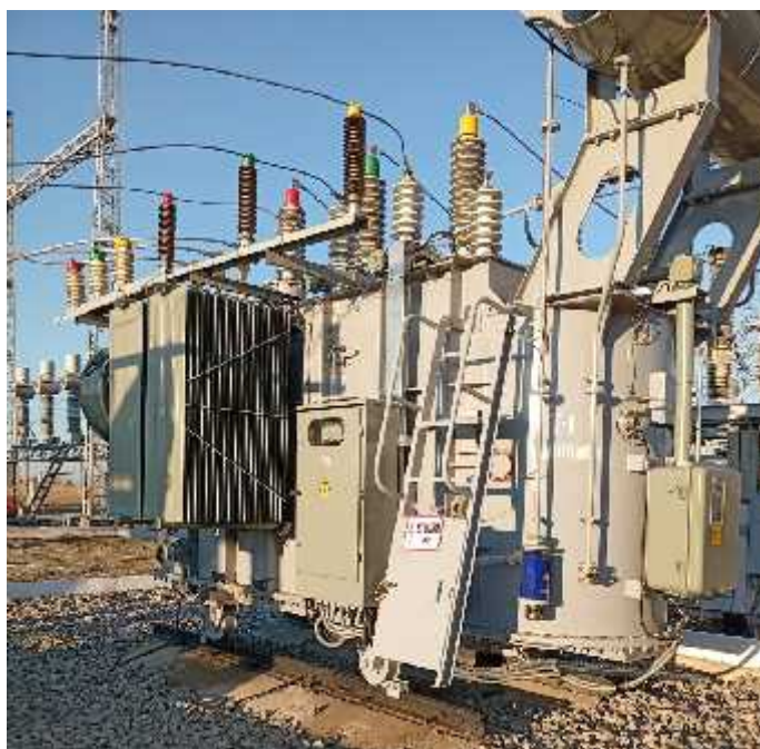
Фото после замены силовых трансформаторов
