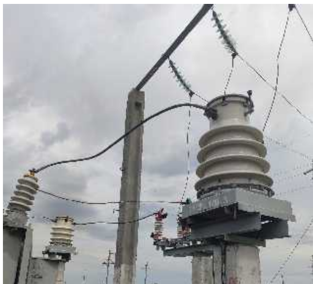
Фото до замены трансформаторов тока 35 кВ
