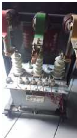
Фото после трансформаторов напряжения 10 кВ
