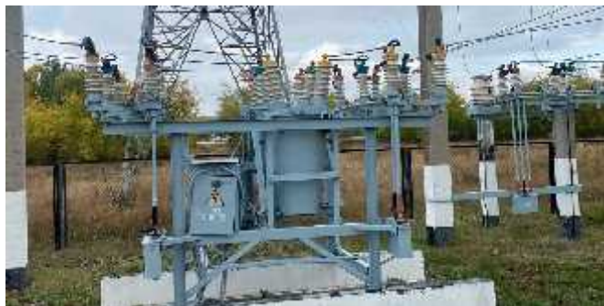
Фото до замены масляных выключателей 35 кВ
