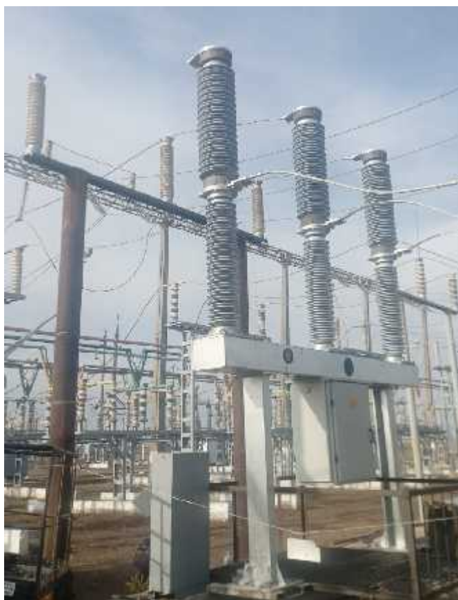
Фото после монтажа элегазового выключателя 110 кВ
