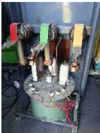
Фото до замены трансформаторов напряжения 10 кВ
