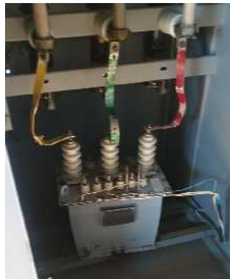
Фото после трансформаторов напряжения 10 кВ
