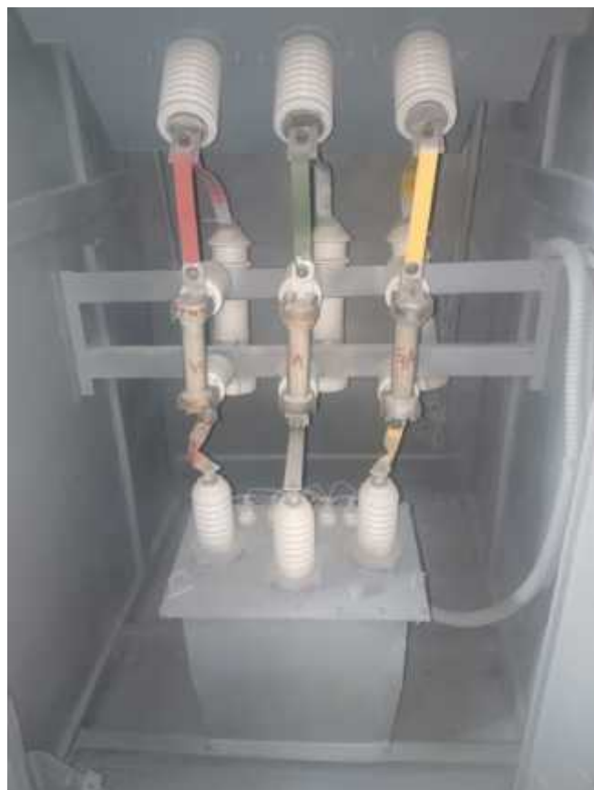
Фото до замены трансформаторов напряжения 10 кВ
