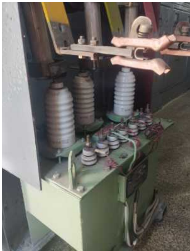
Фото до замены трансформаторов напряжения 10 кВ
