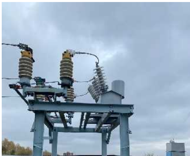
Фото после трансформаторов напряжения 35 кВ
