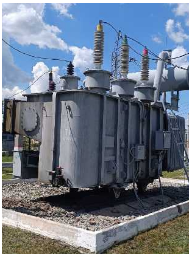
Фото до замены силовых трансформаторов
