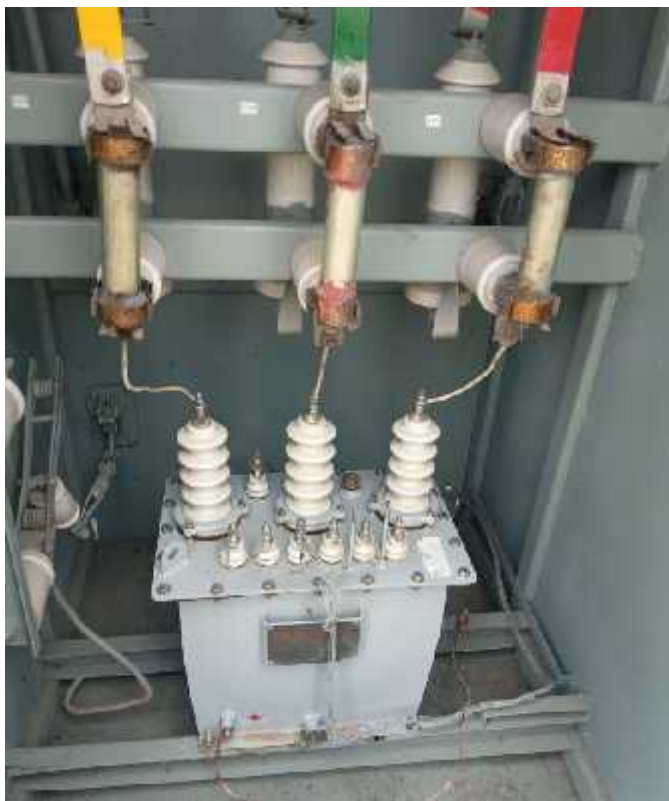
Фото после трансформаторов напряжения 10 кВ
