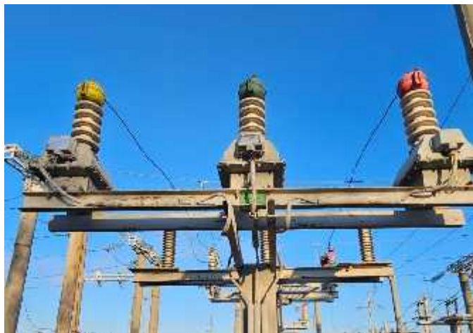
Фото до замены трансформаторов напряжения 35 кВ
