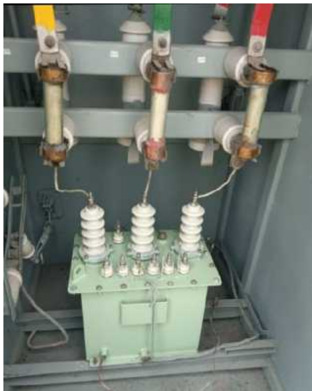
Фото до замены трансформаторов напряжения 10 кВ
