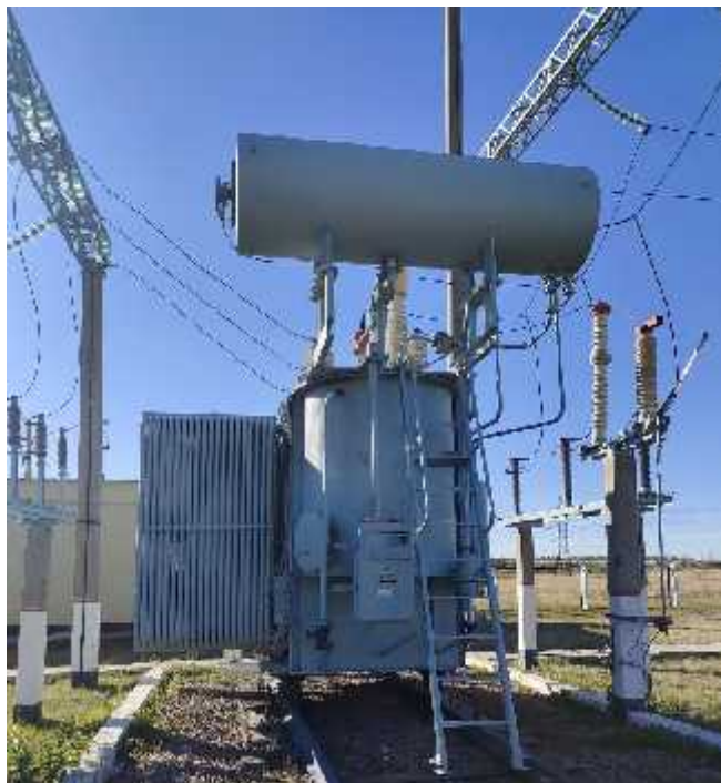
Фото до замены силовых трансформаторов
